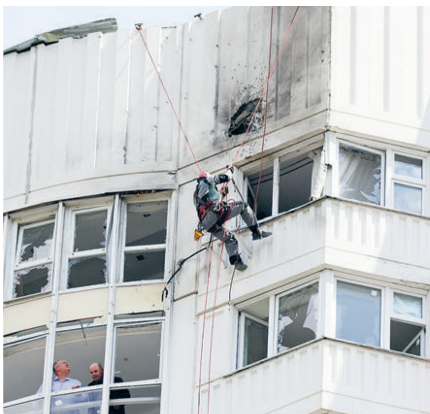
Последствия попадания беспилотного летательного аппарата в жилой многоэтажный дом в подмосковном поселке Московский.
